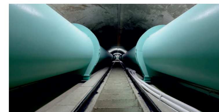
Leitungen aus Stahl
