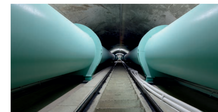
Leitungen aus Stahl
